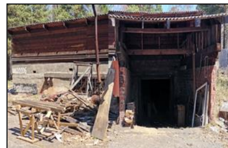
Здание, требующее капремонта
