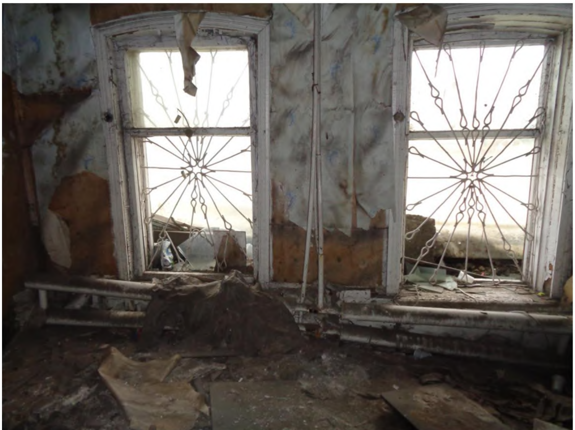
Фото 5, 6. Помещения первого этажа. Деструктивированы нижние венцы сруба. Разрушены цокольное перекрытие, полы, система отопления. Утрачены оконные заполнения. 2023 год.
