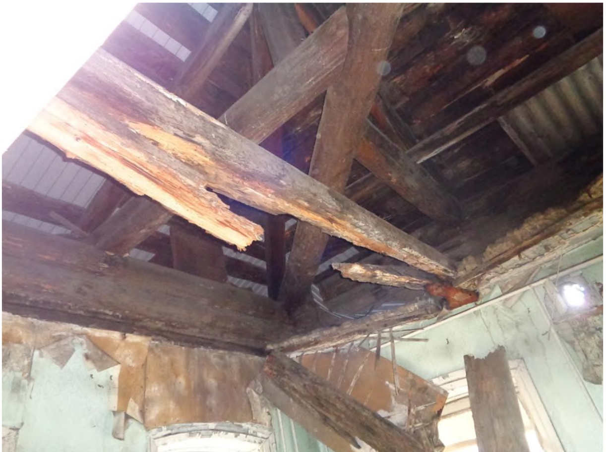
Фото 7, 8. Помещения второго этажа. Чердачное перекрытие и потолок обрушены. Глубокая биодеструкция балок чердачного перекрытия. 2023 год.
