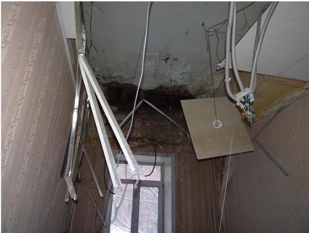
Фото 31, 32. Вывалы штукатурного слоя в пом. 3 и 4 этажей.
