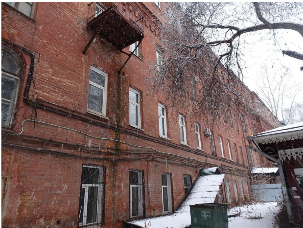
Фото 5, 6, 7. Фрагменты дворового (юго-западного) фасада северо-восточного корпуса. Вертикальные трещины в кирпичной кладке, участки биопоражения.
