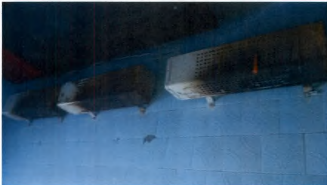
Конвекторы системы отопления, участковая больница с. Бирюлька:
